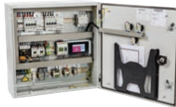
Schaltschrank mit HWAT-ECO v5 eingebaut
